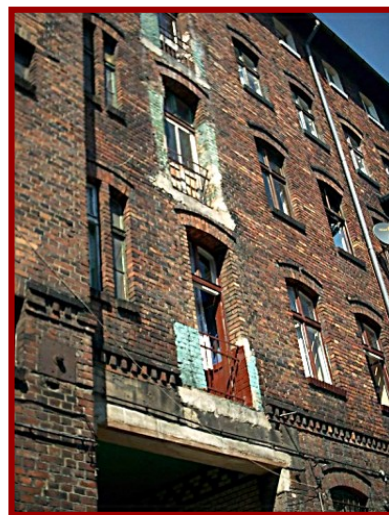
"Unser" Haus heute. Balkone abgerissen.
